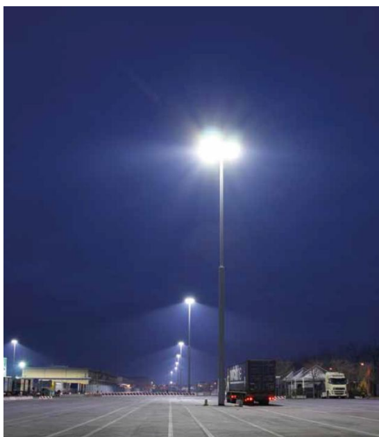
Figura 5.3. Torri faro a LED in funzione al Porto Passeggeri di Venezia
