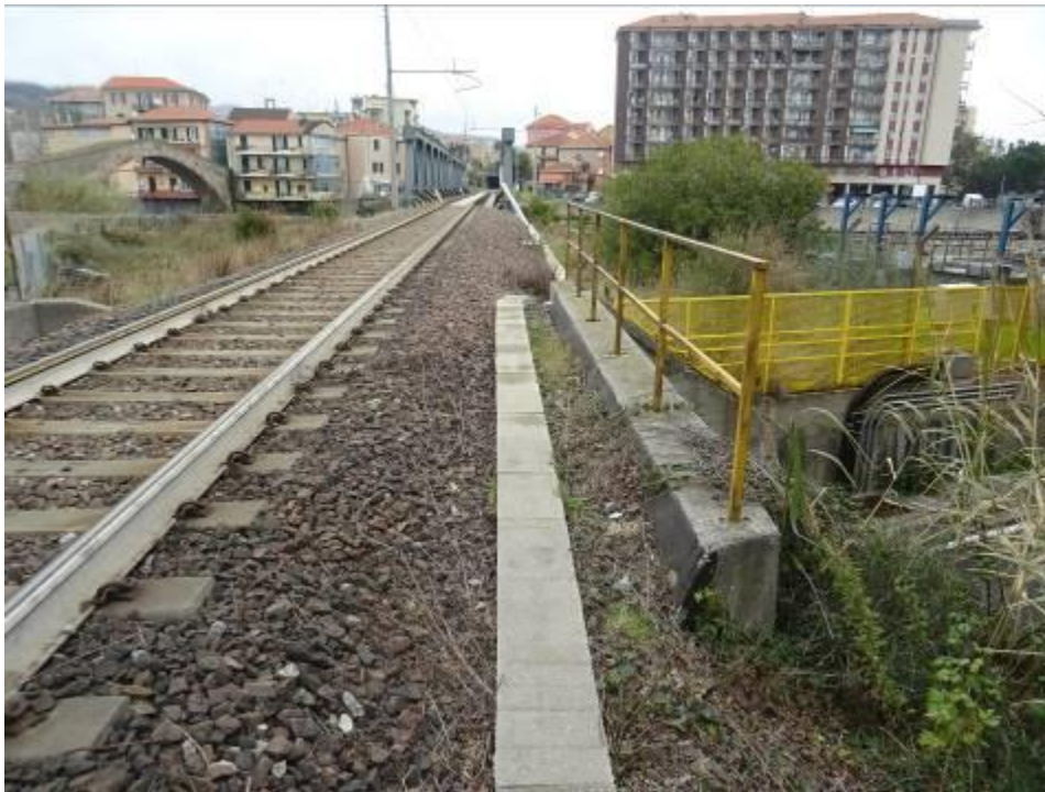
Figura 2: cunicolo affiorante di ingresso nello scalo della dorsale ottica secondaria lato Savona Parco Doria
