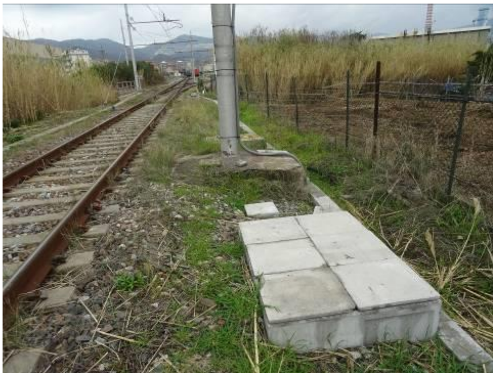
Figura 1: contenitore in calcestruzzo armato che contiene il giunto tra cavo aereo e cavo terrestre, lato Savona Parco Doria km 44+350
