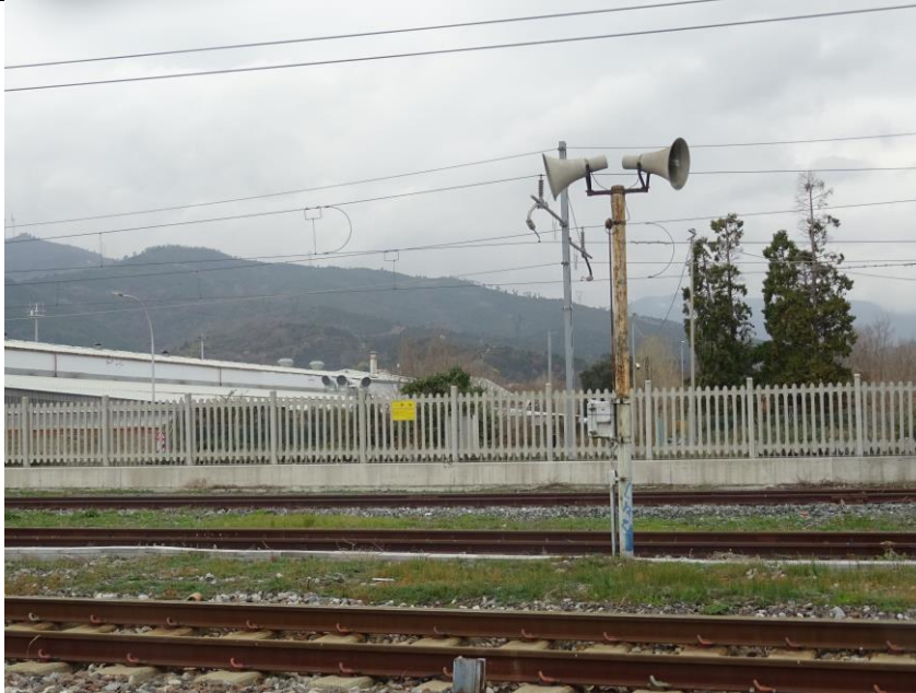
Figura 5: telefono BL da rimuovere sul piazzale lato Est
