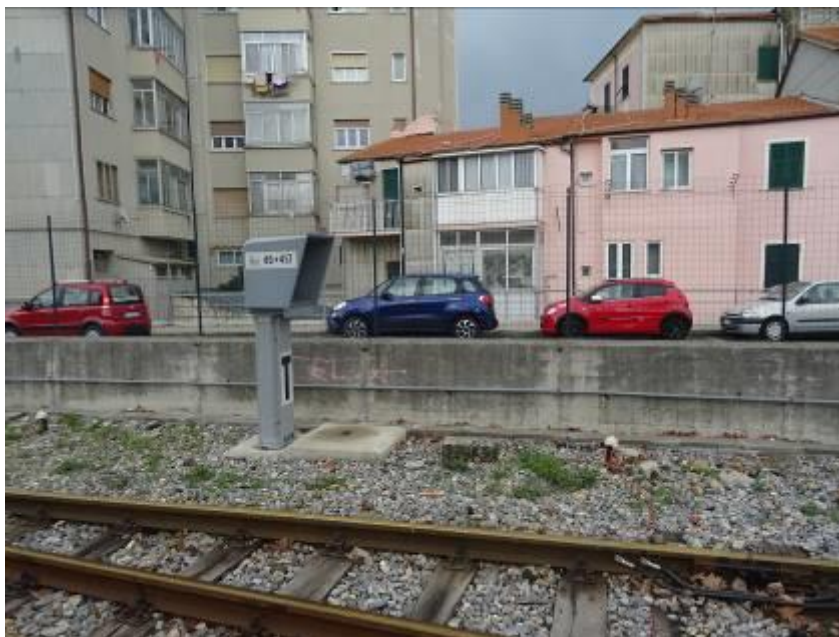
Figura 2: telefono al PL di via Sabazia, da rimuovere
