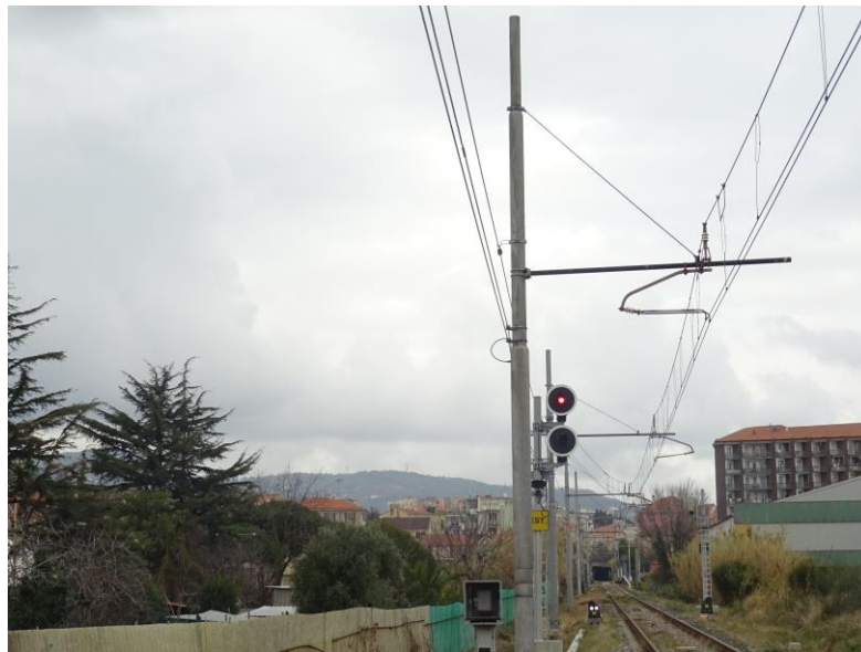
Figura 6: telefono da rimuovere nei pressi del segnale di protezione esterno di Savona Parco Doria
