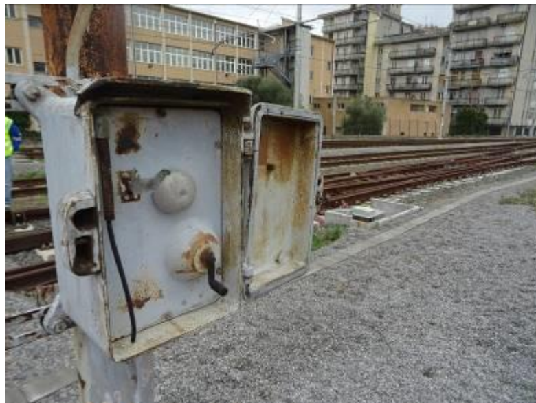
Figura 4: telefono BL da rimuovere lato ingresso raccordo Alstom
