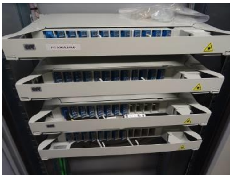
Figura 4: subtelai ottici presso armadio N3 shelter ACC esistente
