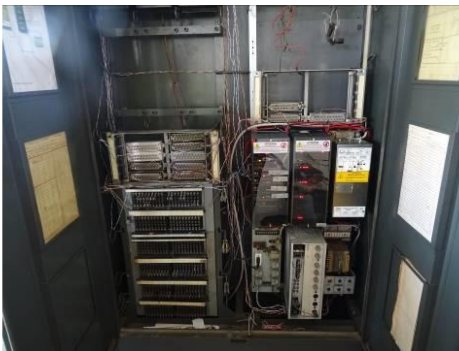
Figura 5: armadio ATPS 24 esistente in ex Ufficio Movimento, a sinistra le terminazioni dei cavi in rame, a destra gli apparati di telefonia e diffusione sonora
