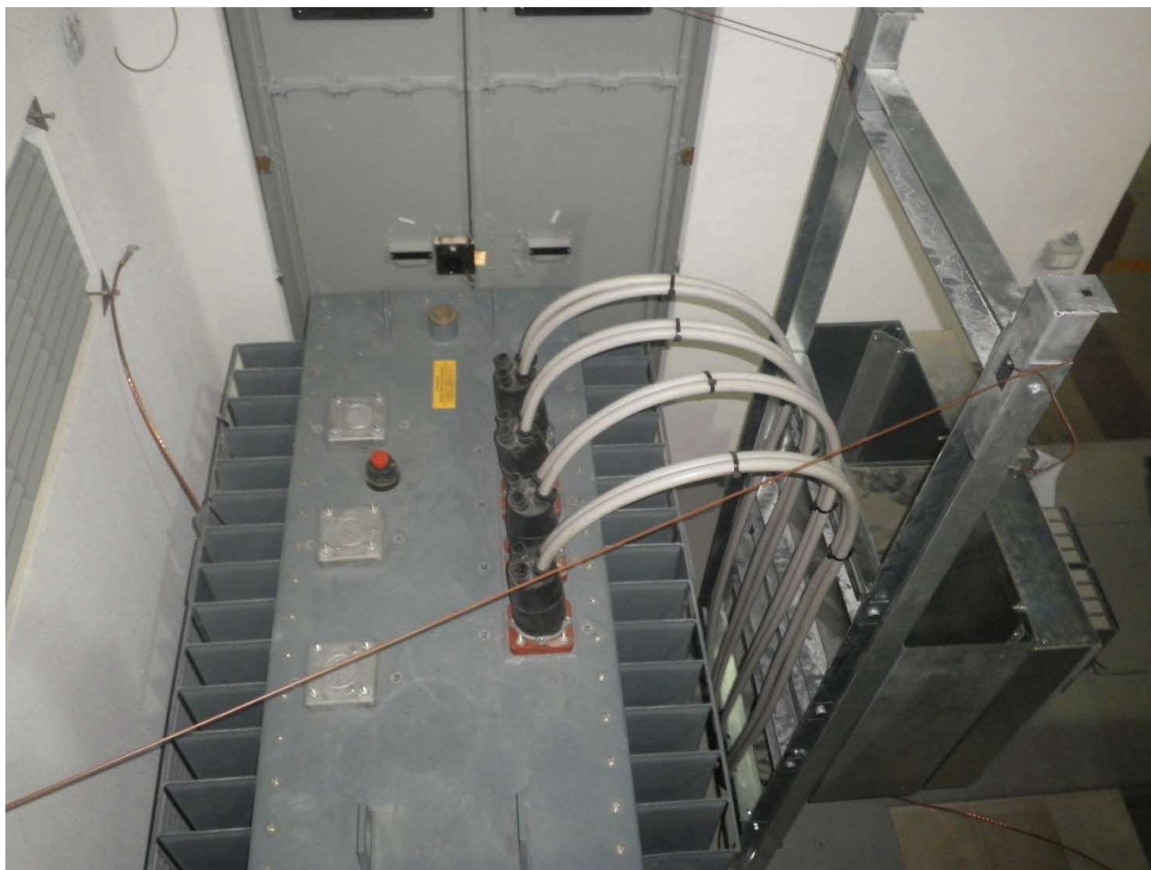
Foto 1 e 2: Esempio di montaggio Quadri BT
