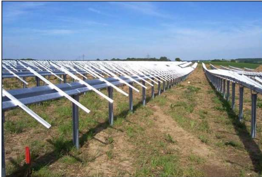
Immagine dei sostegni dei Tracker infissi "a battipalo" nel suolo
