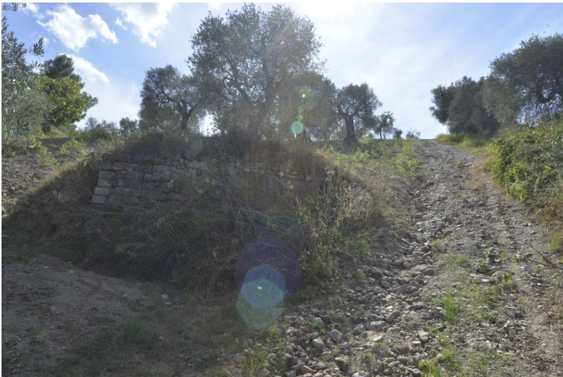
Strada non percorribile
