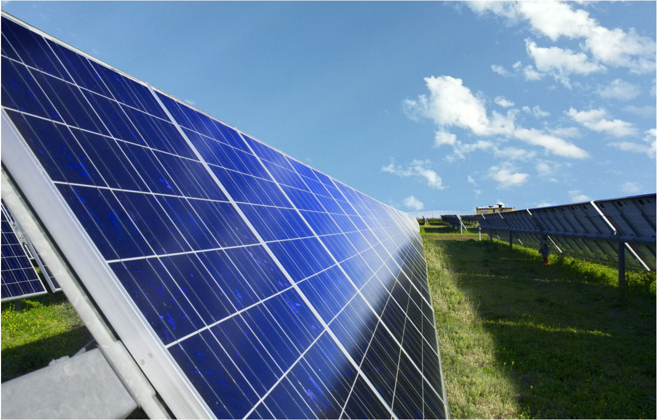
Figura 18 - particolare stringa fotovoltaica
