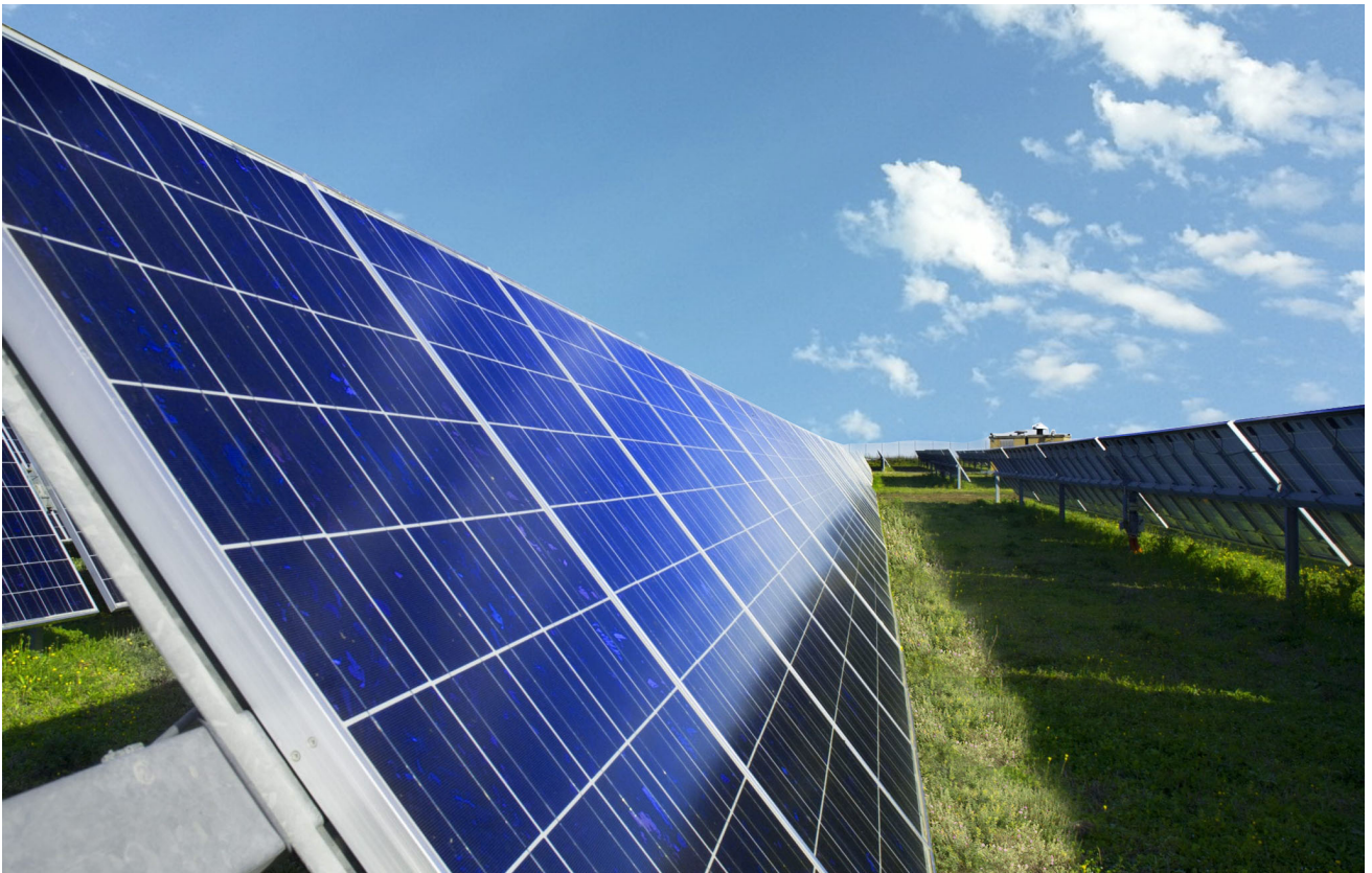
Figura 39 - particolare stringa fotovoltaica
