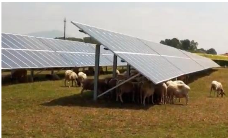
Figura 19 - Greggi di pecore come alternativa all'utilizzo di mezzi meccanici per il taglio dell'erba tra filari di moduli. Nella foto ripresa dal sito internet www.intellienergia.com , i sistemi di ancoraggio sono fissi, ma ovviamente nulla cambia nel caso di sistemi ad inseguimento.
