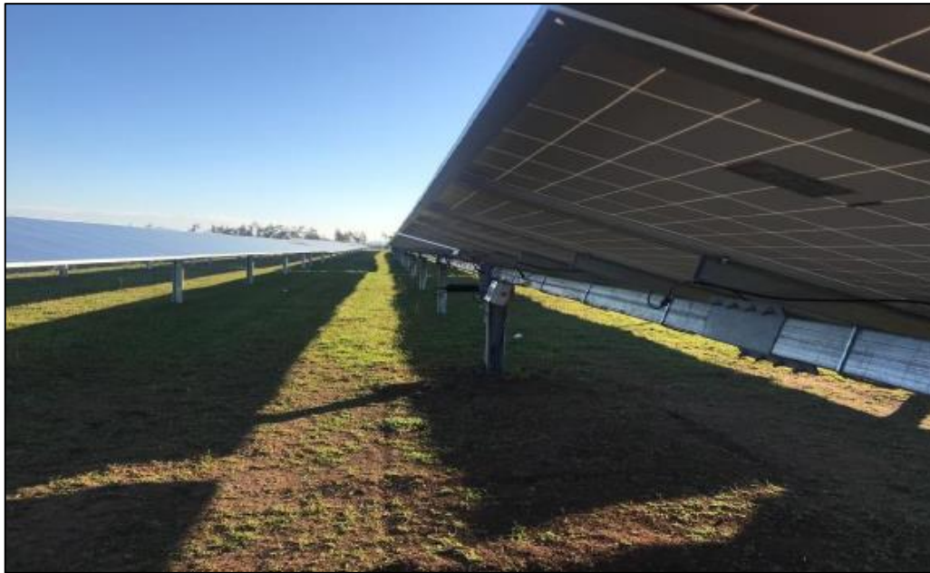
Figura 4 – esempio di struttura inseguitore monoassiale
