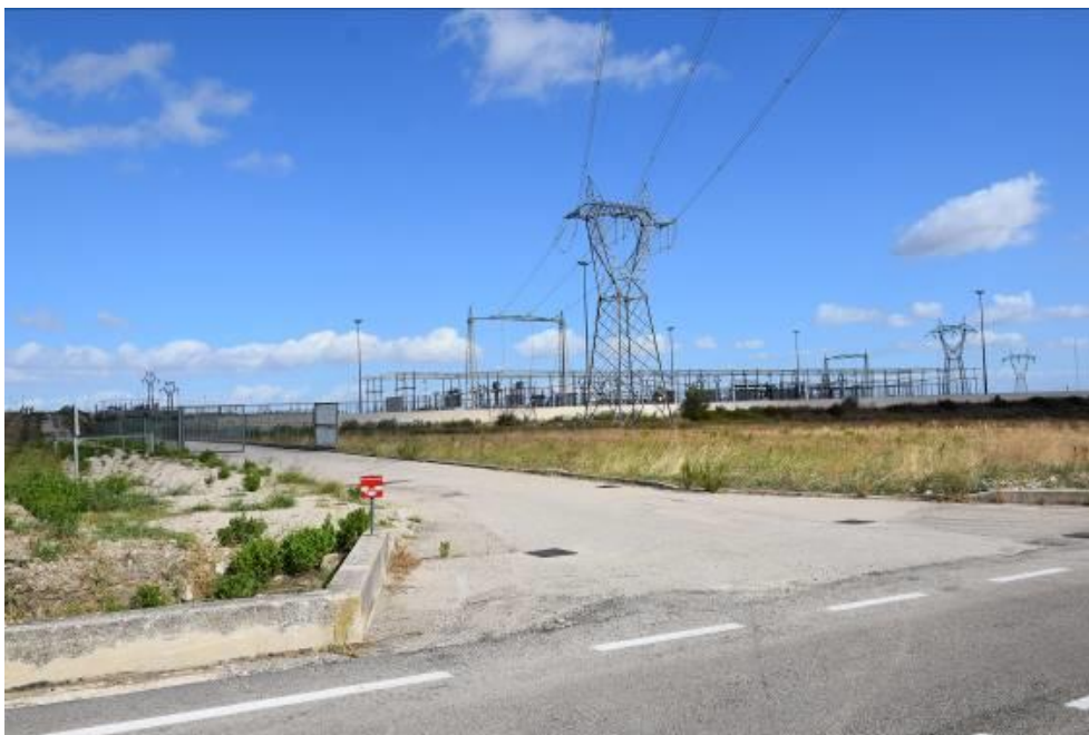
Figura 11 – Vista della SE RTN 150/380 kV Troia
