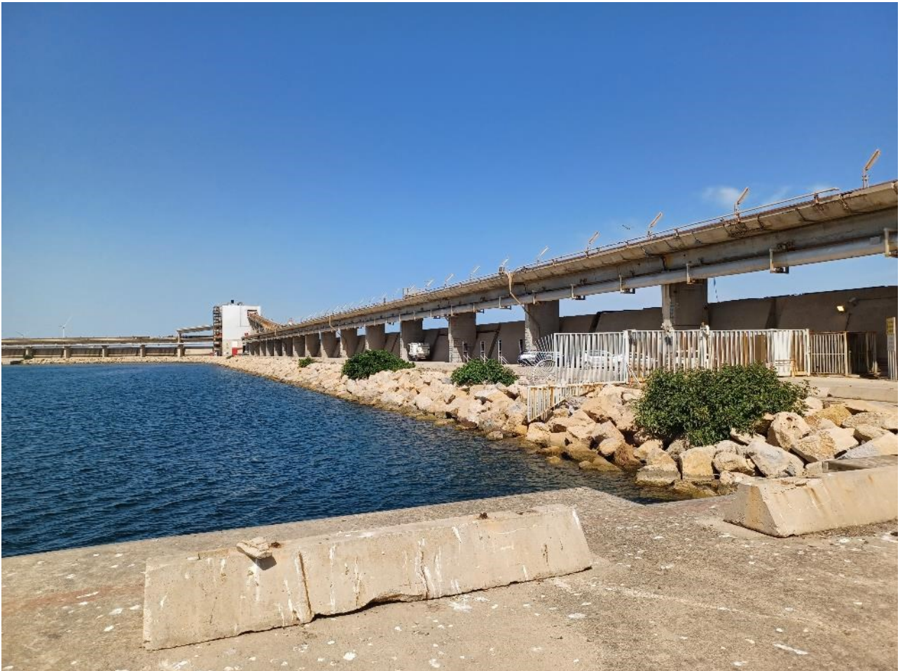
Figura 2.4: Foto No. 04 – Area di Intervento in Banchina, vista da Est. Dettaglio Cannello di Ingresso
