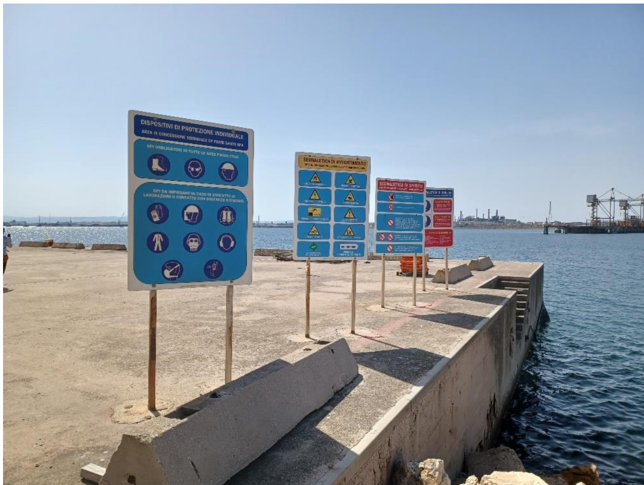
Figura 2.2: Foto No. 02 – Area di Intervento in Banchina, vista da Nord. Dettaglio Cartellonistica di Sicurezza
