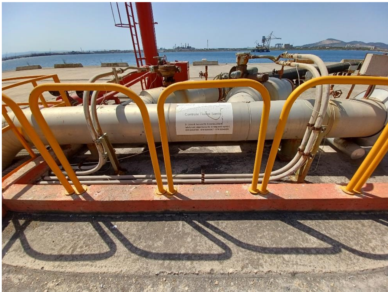
Figura 2.8: Foto No. 08 – Area di Intervento in Banchina, vista da Nord. Dettaglio Manifold
