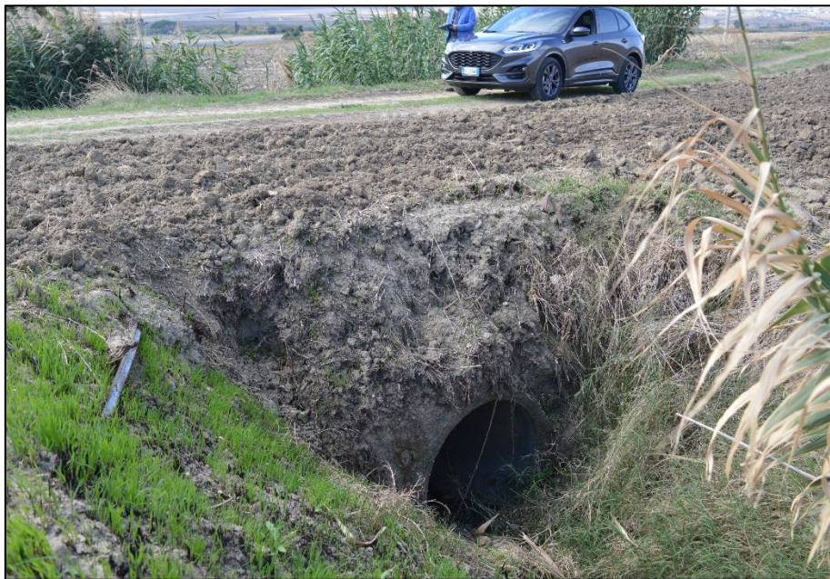
Figura 21: INT.02 – Tubazione di convogliamento delle acque ricoperto in terra
