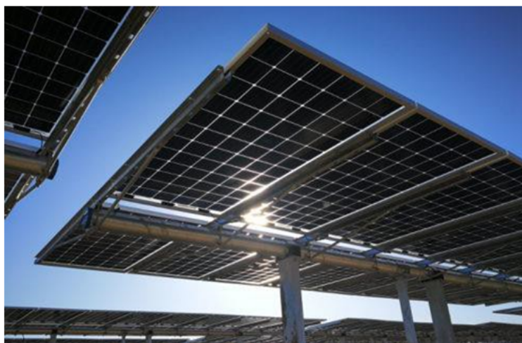
Figura 3.6: Particolare strutture di sostegno moduli
