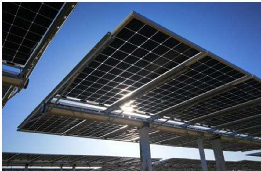
Figura 3.2: Particolare strutture di sostegno moduli
