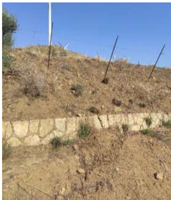
Figura 7 – Terreni colluviali accumulati nella parte inferiore dei versanti a seguito dell'erosione areale
