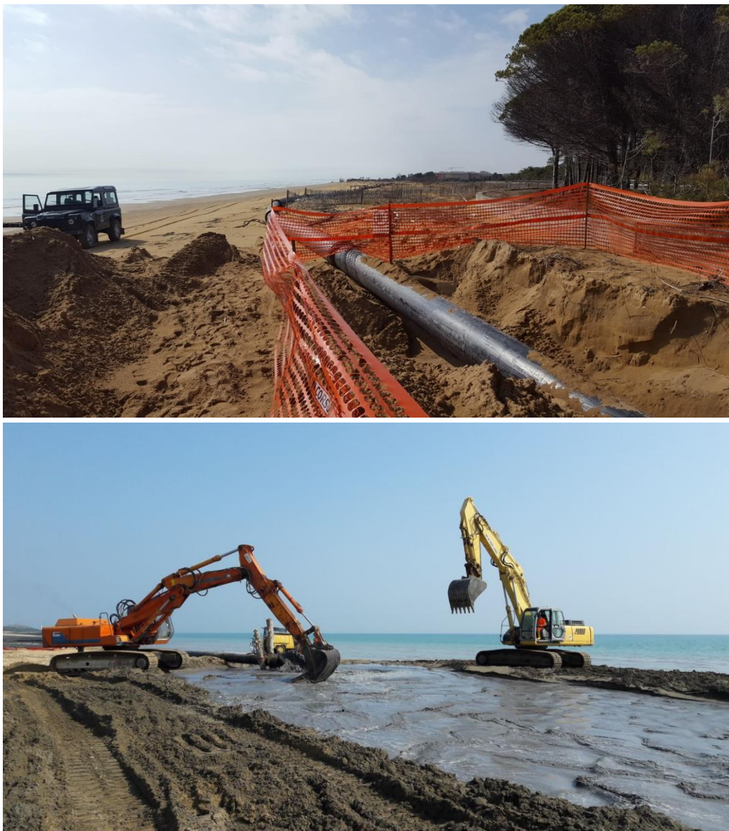
Figura 59: Sabbiodotto di Bibione in esercizio (HS marine, 2019)
