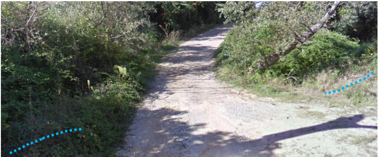
Figura 2-4: il passaggio in corrispondenza del piccolo ponticello. In ciano, l'indicazione dell'asse del Mannara, oltre 1,5 m al di sotto del piano stradale.
