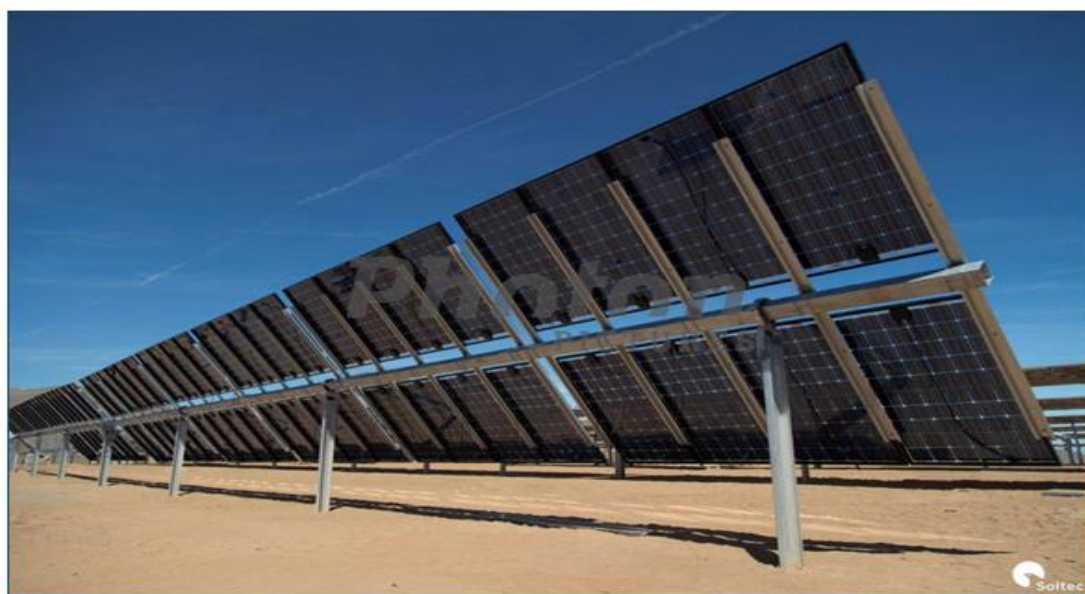
Figura 2-17: Impianto con strutture mobili ad inseguimento monoassiali
