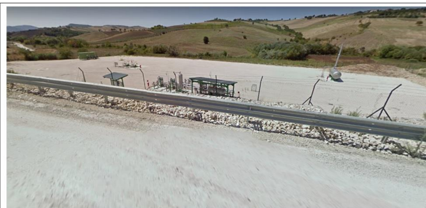
cabina di regolazione pozzo gas
