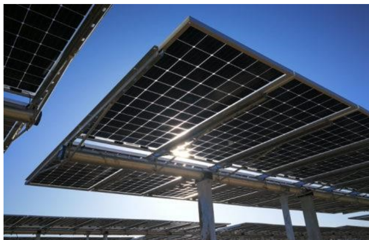
Figura 2-2: Esempio di struttura a tracker monoassiale
