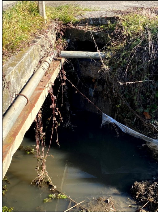
Figura 13. Punto di ripresa lato destro (percorrendo la strada dalla cabina di consegna alla cabina primaria).
