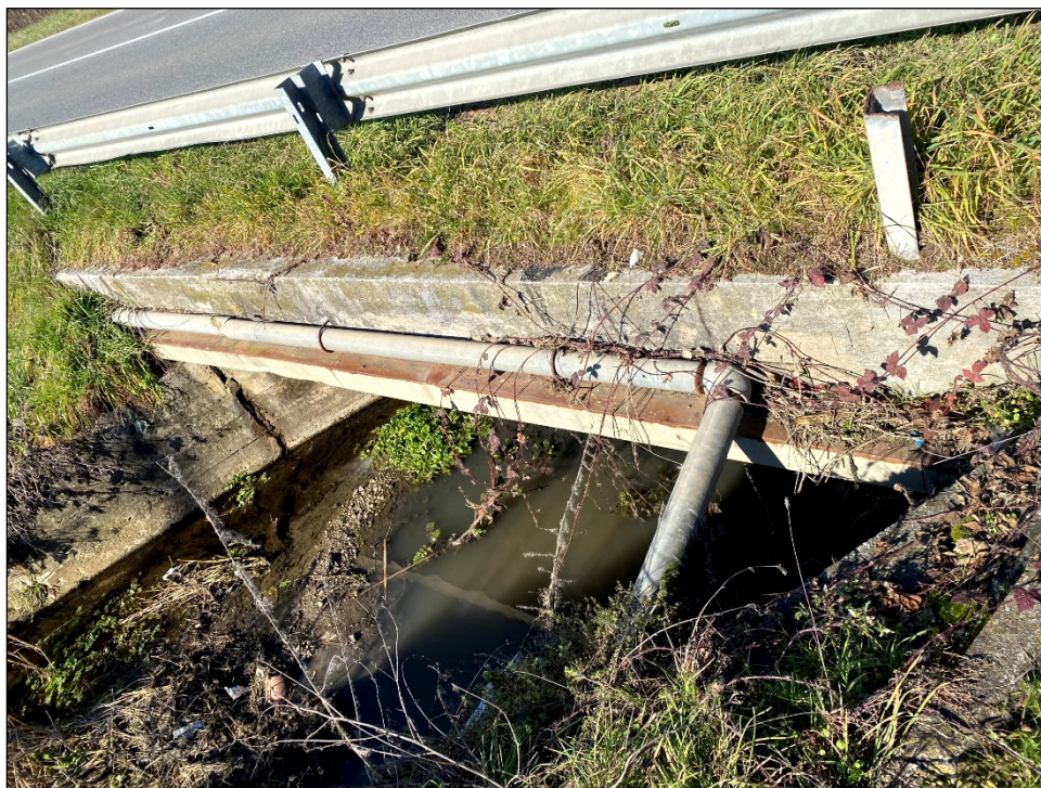
Figura 11. Punto di ripresa lato destro (percorrendo la strada dalla cabina di consegna alla cabina primaria).
