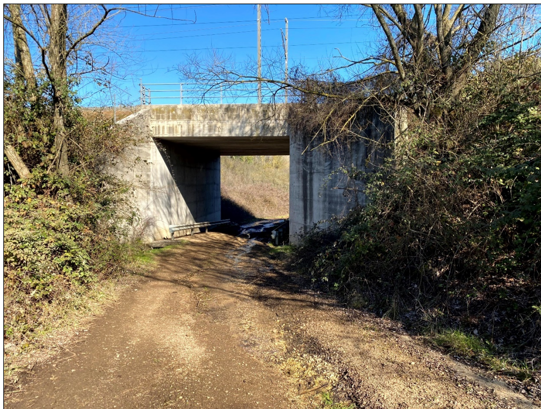
Figura 3. Punto di ripresa lato Sud (percorrendo la strada dalla cabina di consegna alla cabina primaria).
