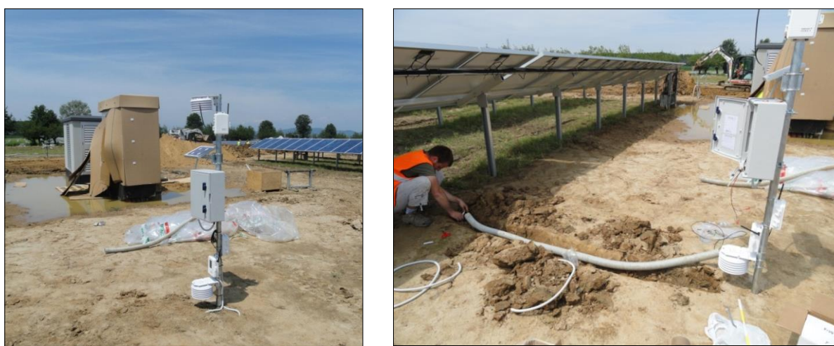
Figura 1. Esempio di stazione di monitoraggio meteo-ambientale e sua installazione (durante la fase di costruzione di in un impianto FV) – realizzata ad opera degli scriventi.
