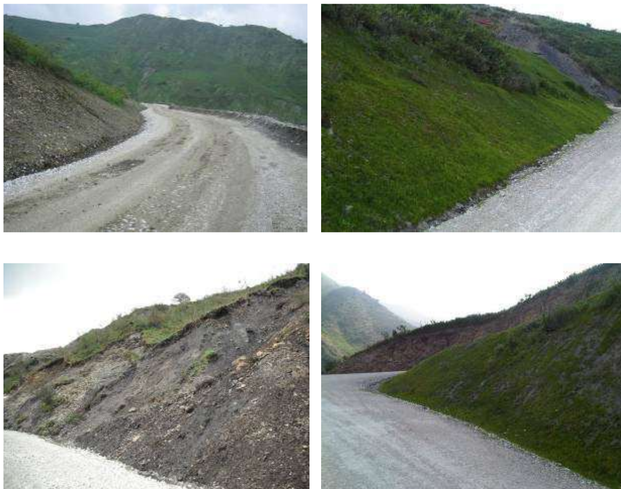
Figura 111 - Esempi di inerbimento post operam delle scarpate oggetto di intervento, ove e se necessari
