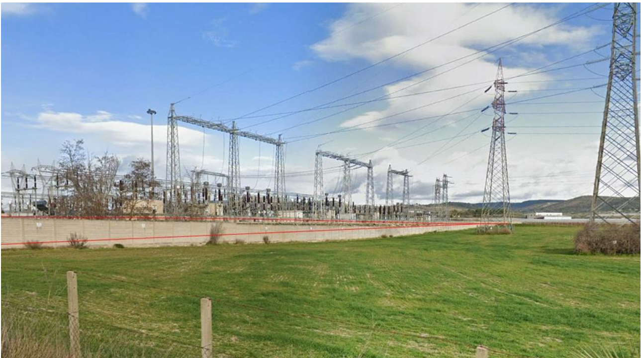
Figura 23 - Stazione TERNA prevista per la connessione alla rete elettrica ubicata in c. da Pantaleo nel territorio comunale di Chiaramonte Gulfi
