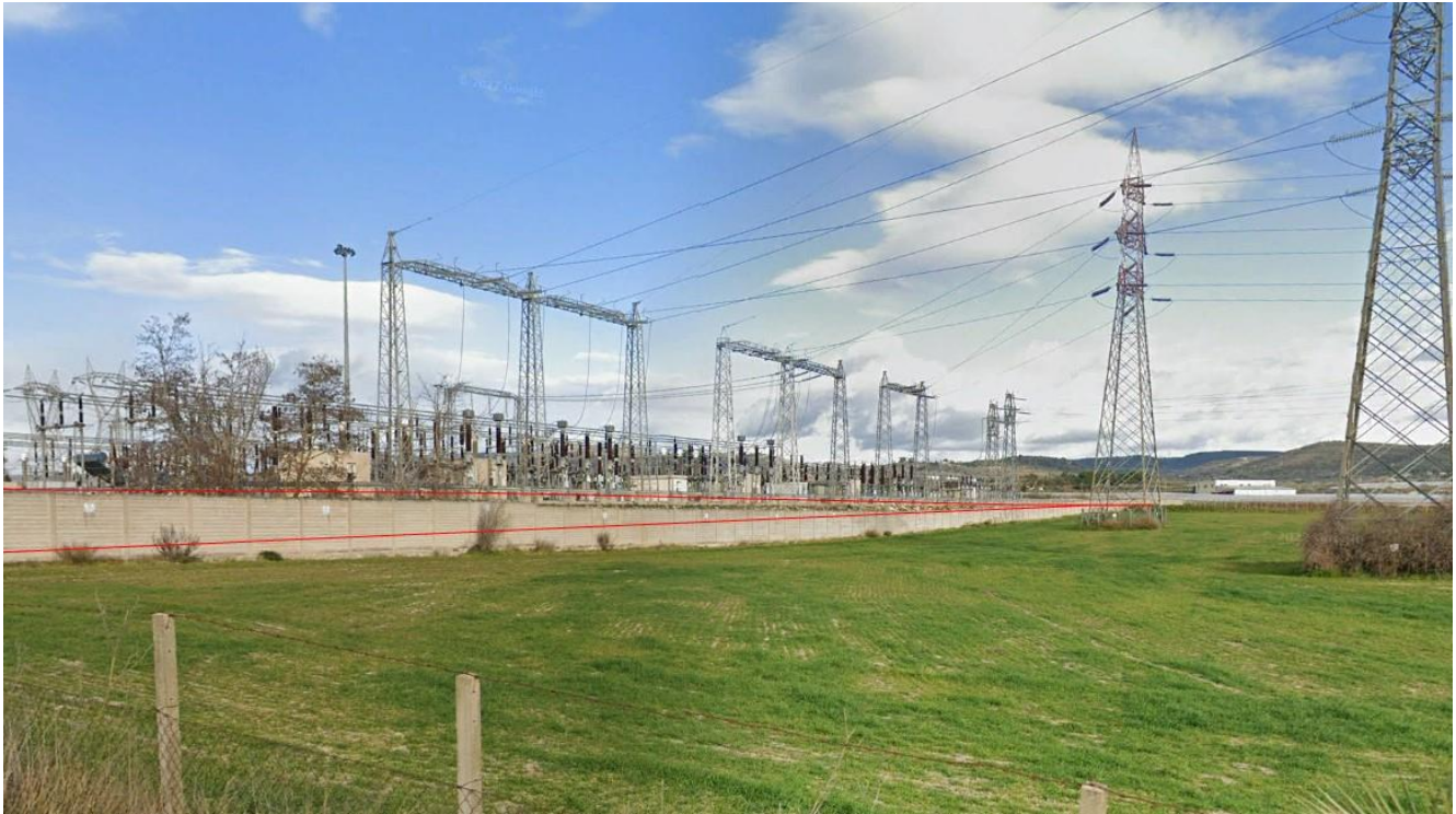
Figura 13 - Stazione TERNA prevista per la connessione alla rete elettrica ubicata in località di Chiaramonte Gulfi
