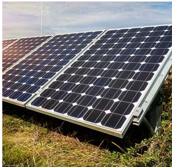
Figura 20: Impianto fotovoltaico con moduli di tipo monocristallino 1/2
