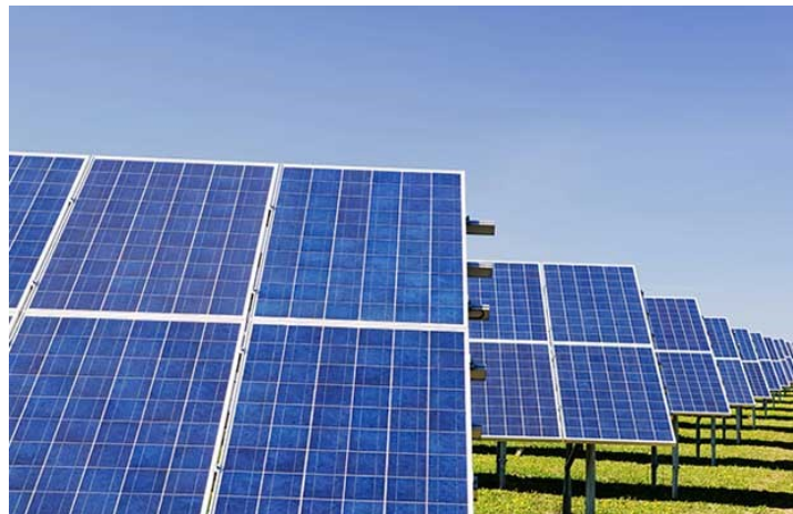
Figura 21: Impianto fotovoltaico con moduli di tipo policristallino 2/2
