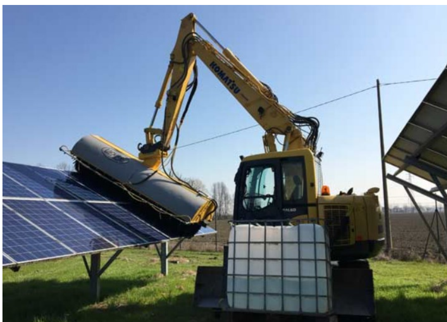
Figura 50: Esempio pulizia pannelli
