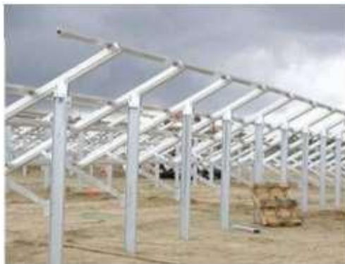
FIGURA 10 - STRUTTURE DI SOSTEGNO (TRACKER)
