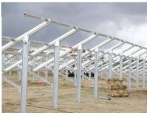
FIGURA 3 - STRUTTURE DI SOSTEGNO (TRACKER)
