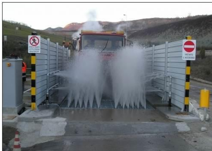
Impianto lavaggio ruote
