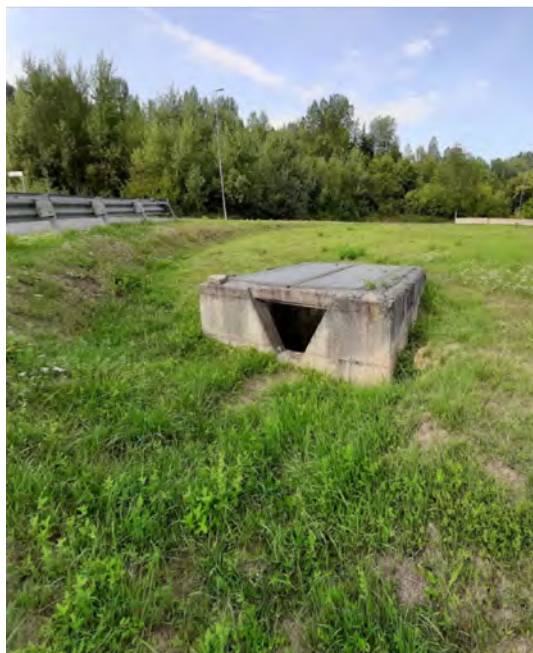
Tratto tombato in corrispondenza della rotatoria a prato davanti Caserma VV.FF. – Pozzetto ispezionabile
