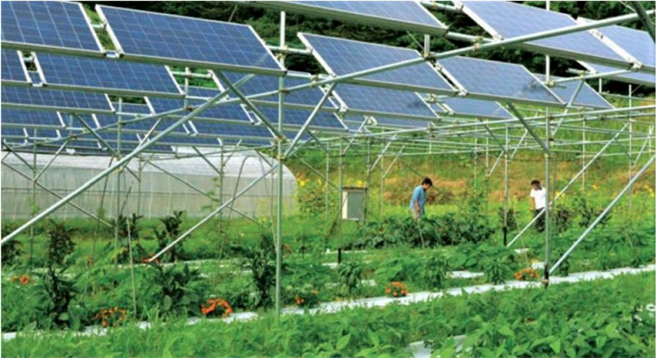
Impianto tipo – Fonte: Web
