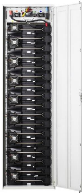
Figura 7 Esempio rack batterie
