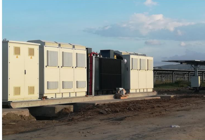
Figura 12 Esempio skid conversione
