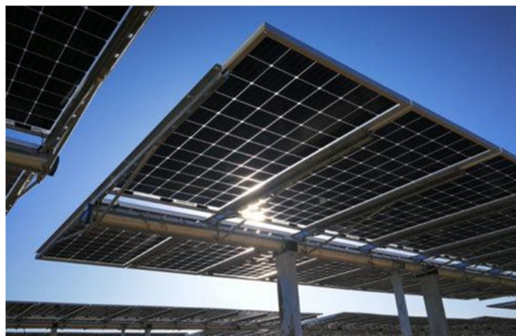
Figura 1-1: Particolare strutture di sostegno moduli
