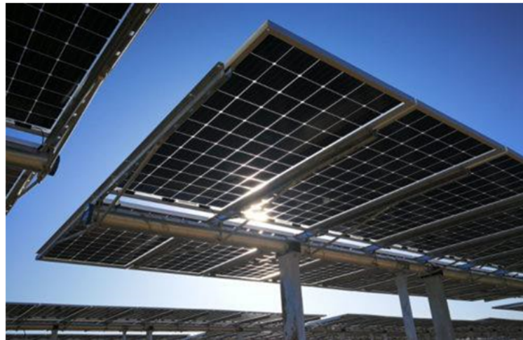
Figura 5.1: Particolare strutture di sostegno moduli
