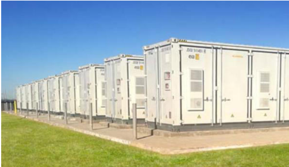
Fig. 3.2.22 – Modello tipo di container delle cabine di accumulo
