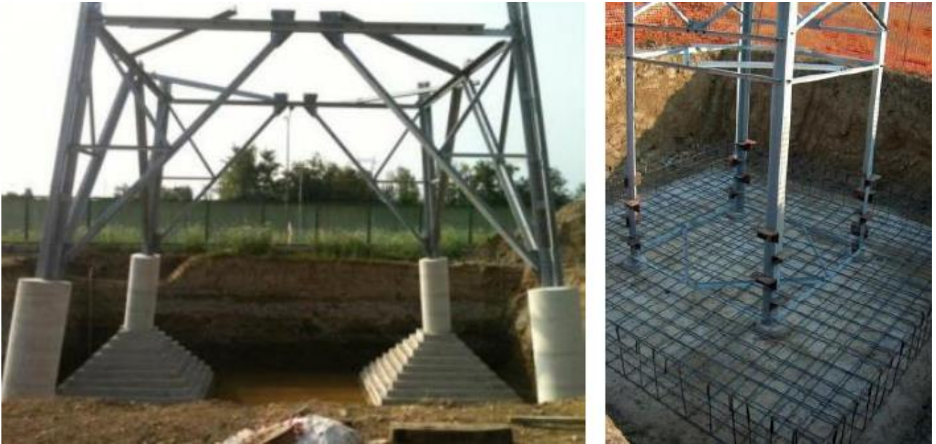
Figura 2-2: esempio di scavo e fondazione a piedini separati (a sinistra) e a blocco unico (a destra).
