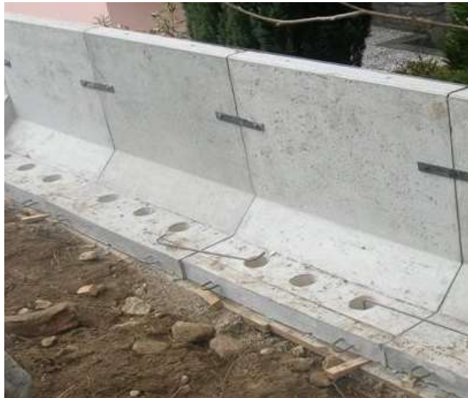
Figure 11-10: Barriera di contenimento – foto
