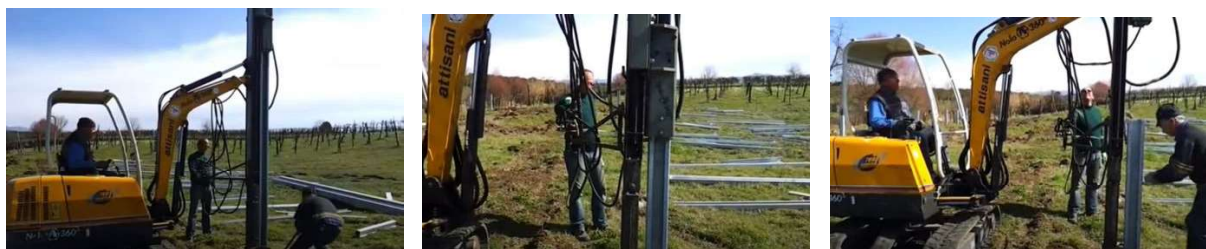
Sequenza fotografica che mostra l'infissione eseguita con battipalo di pali in acciaio ad omega per pannelli fotovoltaici.
