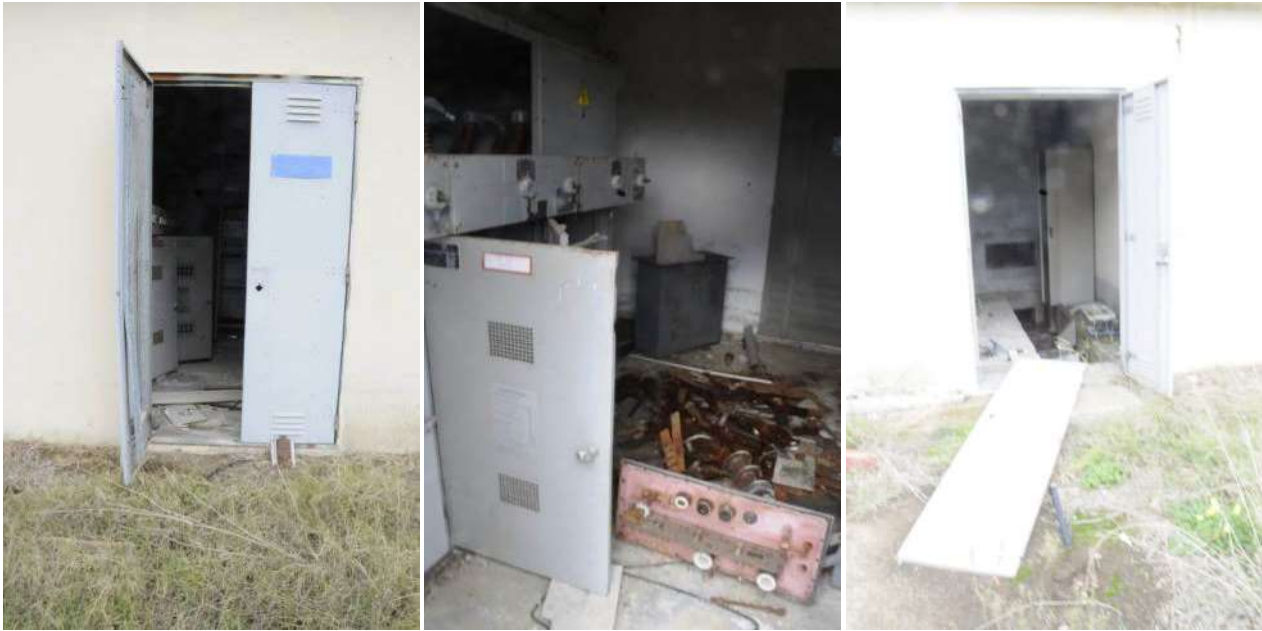
Il centro aziendale, così come tutti manufatti, si presentano in cattivo stato di manutenzione.
