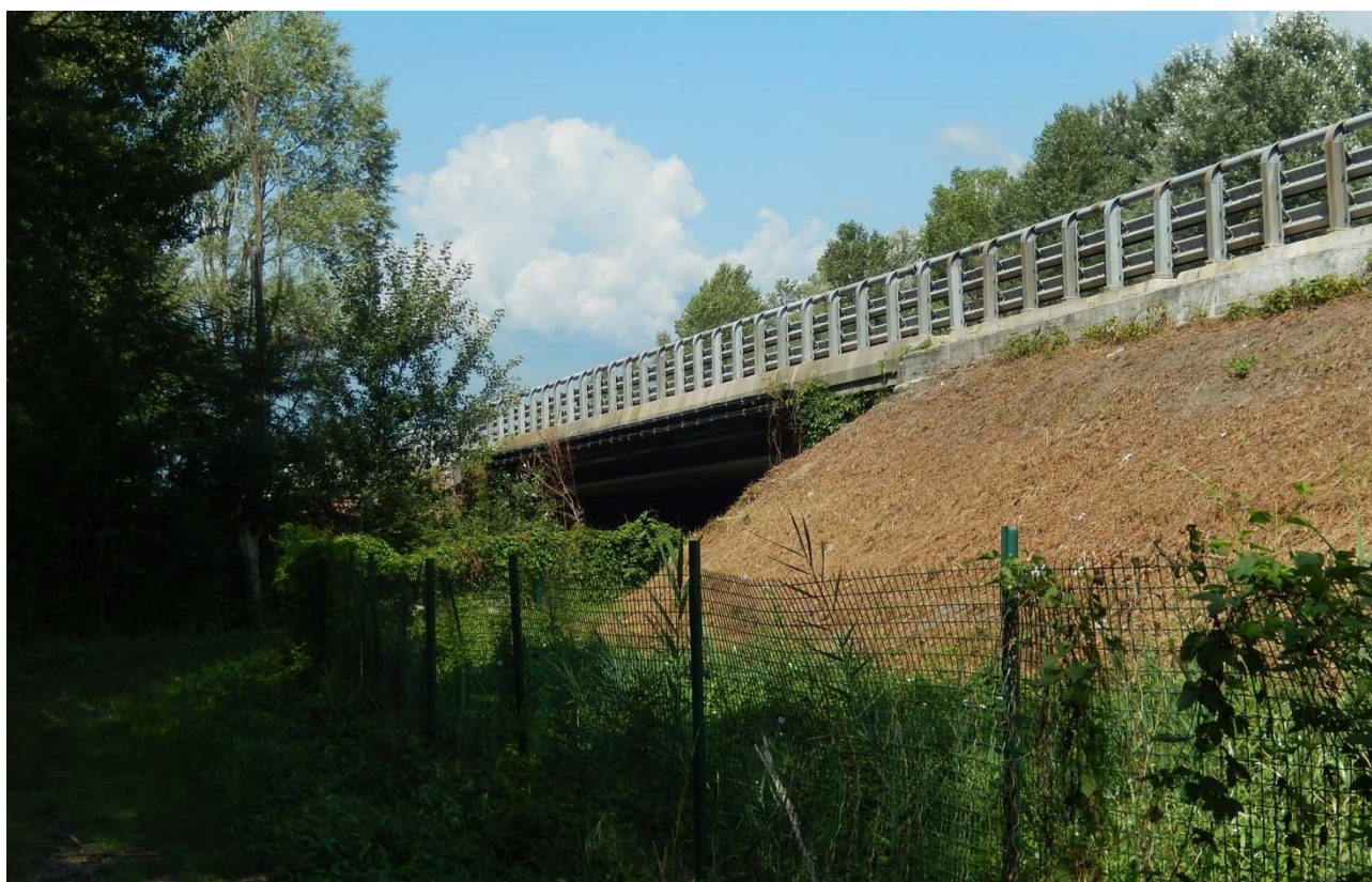
Figura 33 – Ponte di attraversamento del canale di scarico del NIE. Ripresa da est
