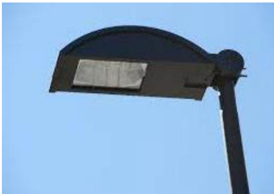
Figura 4.41: Esempio di apparecchio completamente schermato (full-cut-off).
