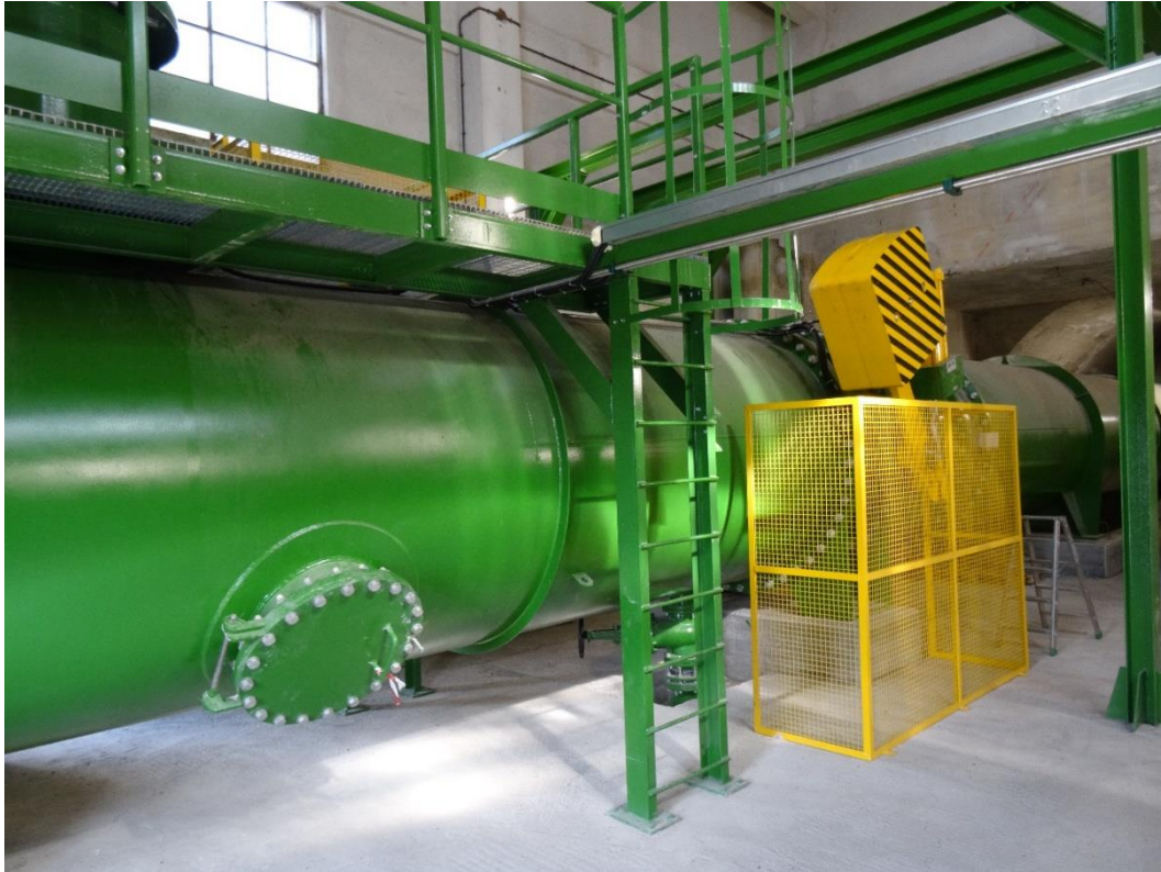
Figura 13: Interno camera valvola – Sopralluogo Lombardi 2021.
