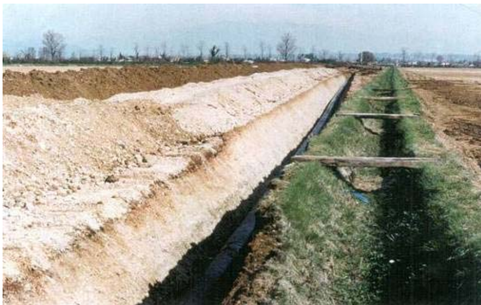
Foto 2.2-4: Tratto di condotta posata, si noti l'accantonamento dello strato humico separato dal materiale di scavo della trincea
