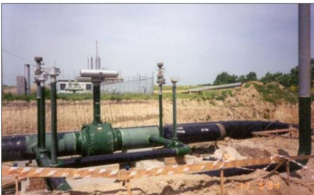
Foto 2.2-8: Esempio di punto di intercettazione di linea (PIL)
