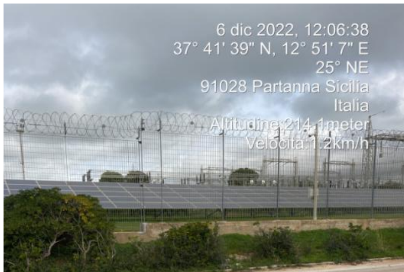
Figura 73. Punti di Misura 2, Stazione elettrica Partanna.
