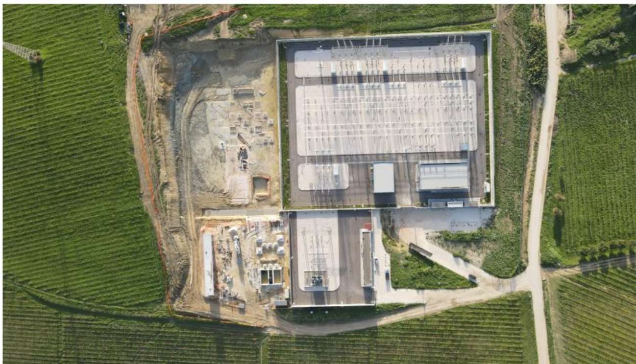
Figura 71. Posizionamento Stazione "Partanna 2" e ampliamento in fase di cantiere (fotografia aerea scattata in data 28.11.22).
