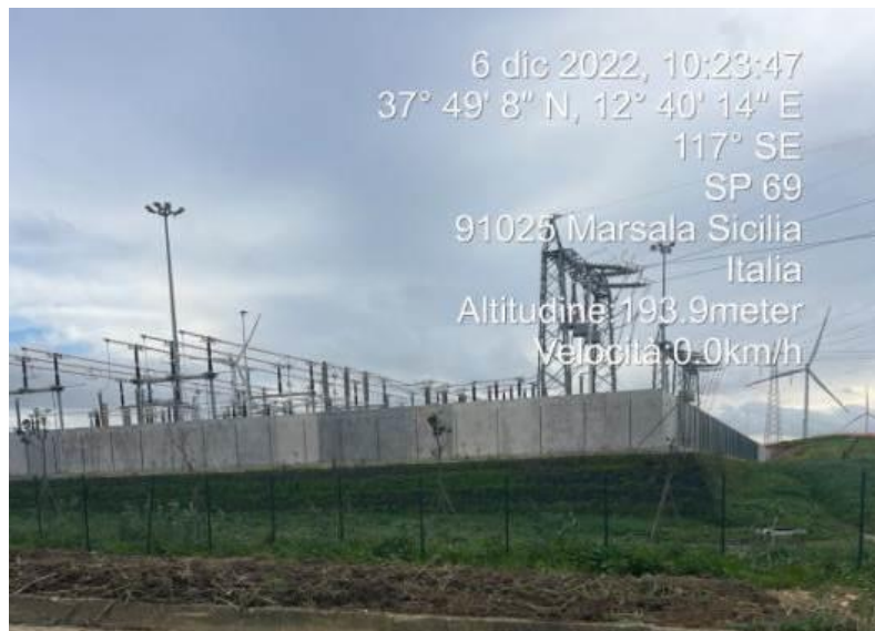
Figura 72. Punto di Misura 1, Stazione elettrica Partanna 2.
