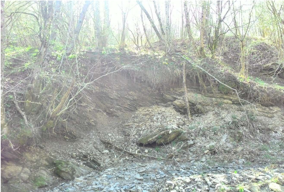
Figura 34. Nicchia di distacco di una frana di crollo osservata a ridosso del letto del Trebbia. Punto di rilievo n°69.
