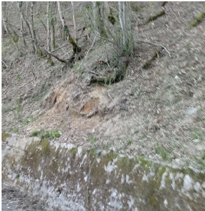
Figura 39. Frana puntuale osservata in corrispondenza della strada secondaria sottostante il punto di rilievo n°38.
