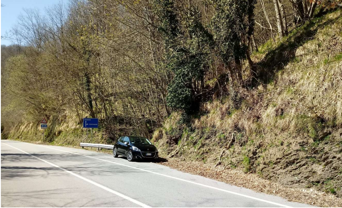
Figura 40. Scavi di sbancamento realizzati durante la costruzione della S.S.45. Si noti la presenza continua di tali scarpate rocciose poste a monte dell'infrastruttura. Tratta compresa tra i punti di rilievo n°31, n°11 e n°10.
