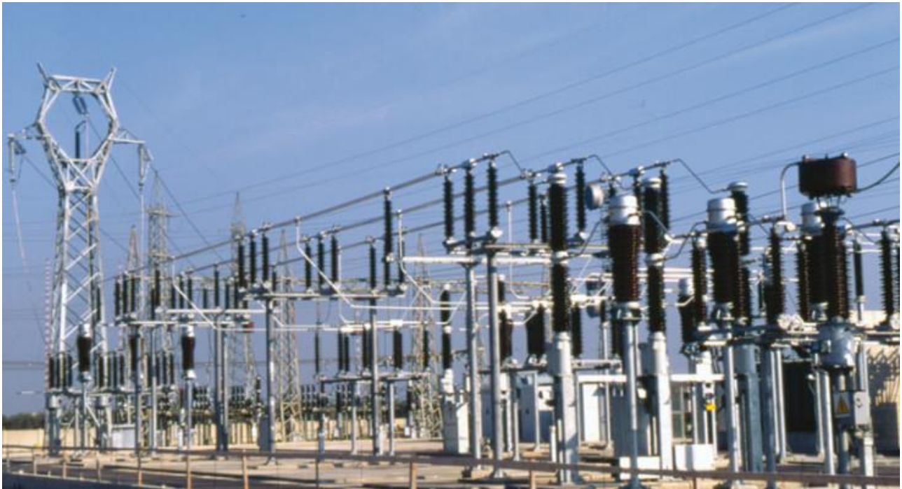
Figura 29 - Esempio di aspetto di stazione AT RTN - fonte Web, free license
