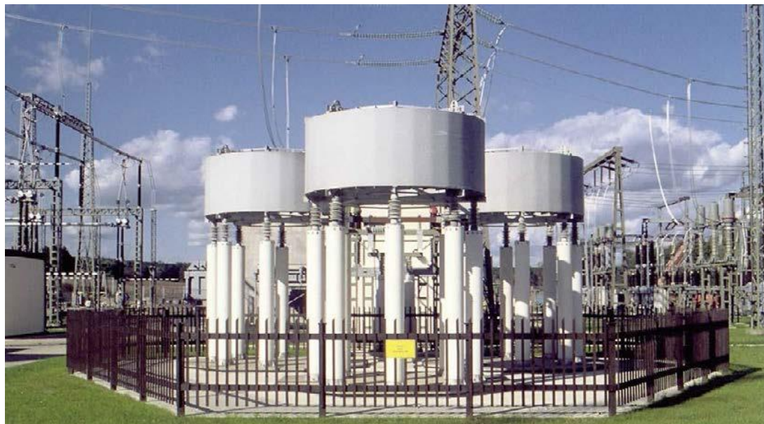
Figura 36 - shunt capacity reactor - fonte Siemens
