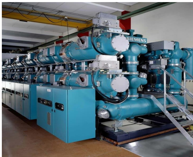
Figura 16 - Celle AT 380kV in stazione Off-shore (fonte Siemens)
