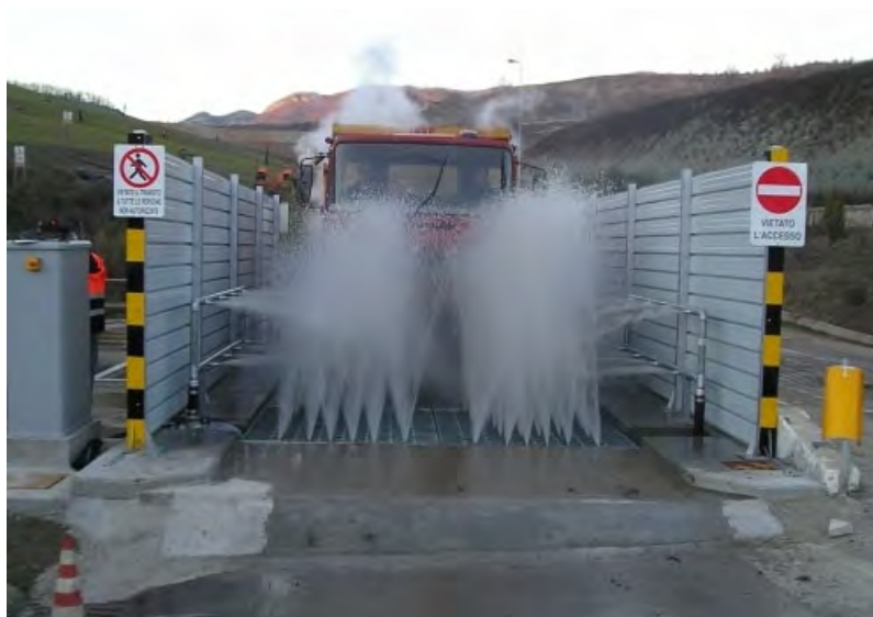
Figura 7.8 – Impianto lavaggio gomme e mezzi
